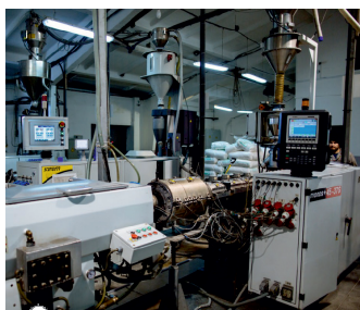
Цех по производству канализации
