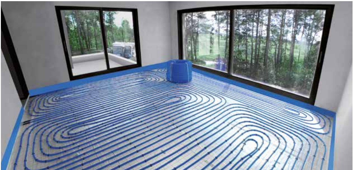
Рис. 3. Система напольного отопления в частном доме при использовании труб bluePERT и системы крепления труб KAN-therm Tacker.
