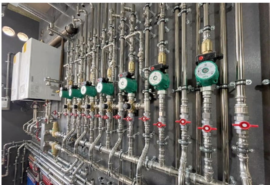
:: Фото 1. Пример использования стальных хомутов в котельной частного дома в Подмоскowie. Обвязка выполнена из нержавеющей труб
